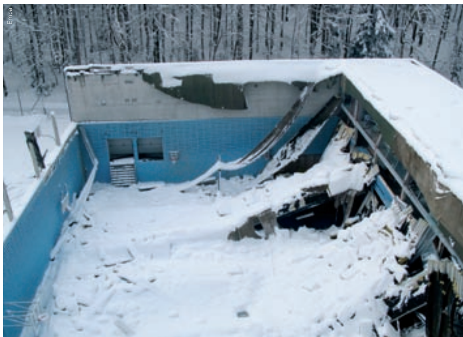
Die Riethüsli-Turnhalle in St. Gallen kurz nach dem Einsturz letzten Winter.
